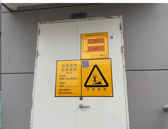
危险废物暂存间标牌(外部)
