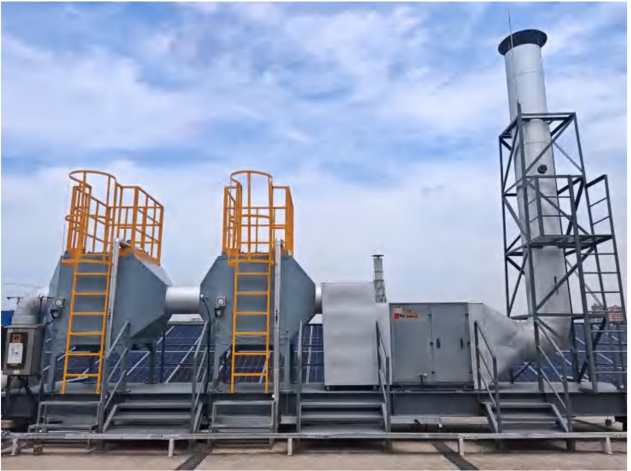
实验室废气处理设施（二级活性炭吸附）和 DA001 排气筒
