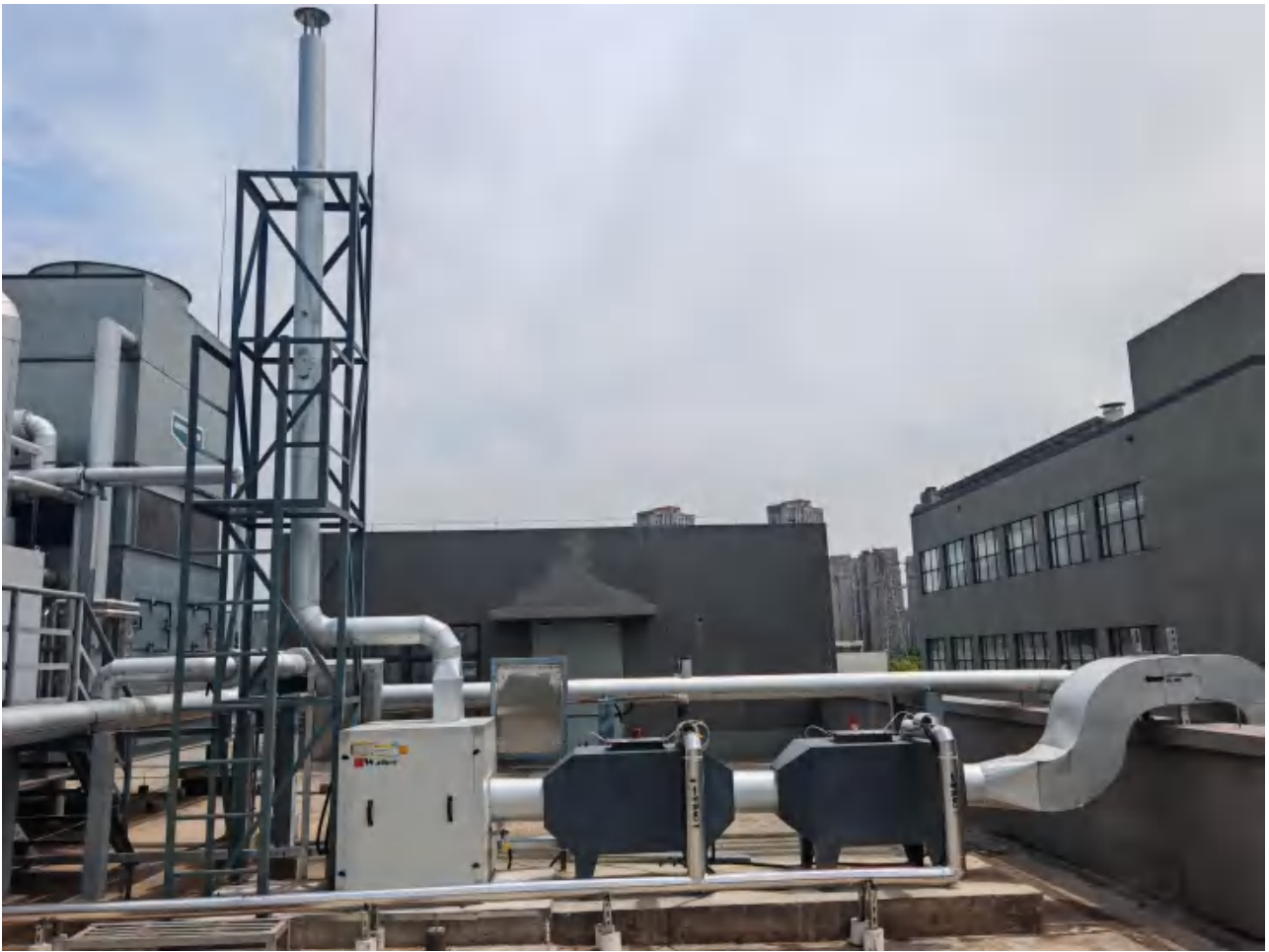
危废仓库废气处理设施（活性炭吸附）和 DA002 排气筒
